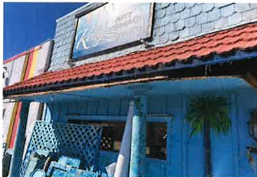
Rotten soffit, trim
